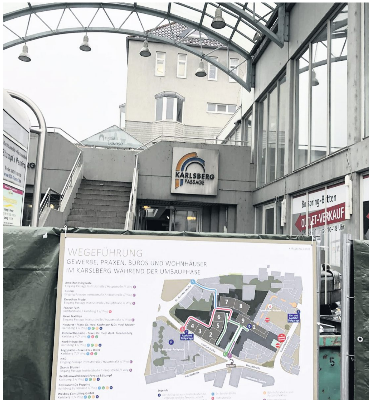
Von der Bahnhofstraße (Bild) und vom Atrium aus kann man die Geschäfte in der Karlsbergpassage wegen der Umbauarbeiten nicht mehr betreten. Das ist nur noch von der Institutstraße aus möglich. Der Plan zeigt, wie Fußgänger die Arxtpraxen und Büros erreichen. BILD: PRO
